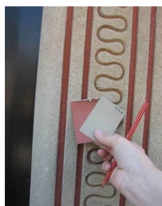
Contratipat cromàtic in-situ
